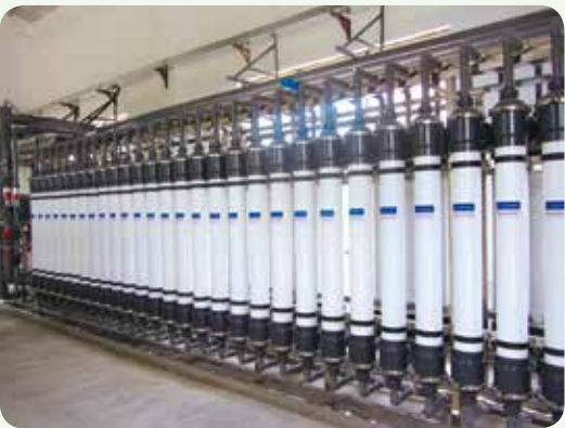
珠海华丰中水回用项目超滤系统
