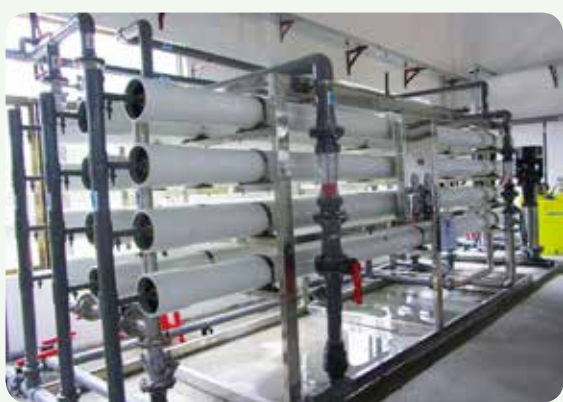
中水回用项目 RO 膜反渗透系统
